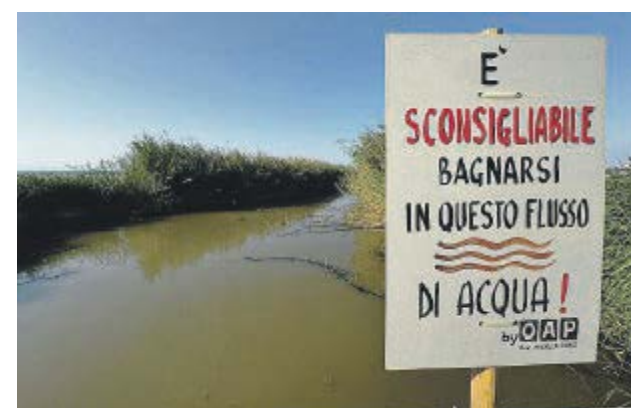
La zona incrinata a ridosso del canale che dovrebbe raccogliere solo acque piovane e dove sono in corso dei lavori
